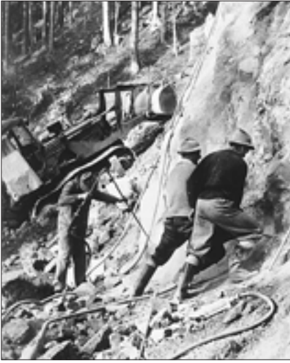
Die Arbeiter bohren mit Pressluft die Löcher zur Sprengung in den Felsen. Links rückwärts räumt eine Raupe den Sprengschutt ab. Dann wird der Schutt zu Kies zerkleinert. Die Maschine dazu, genannt „die Quetsch“, hatte die Firma Plenk von Engedey zur Verfügung gestellt.
